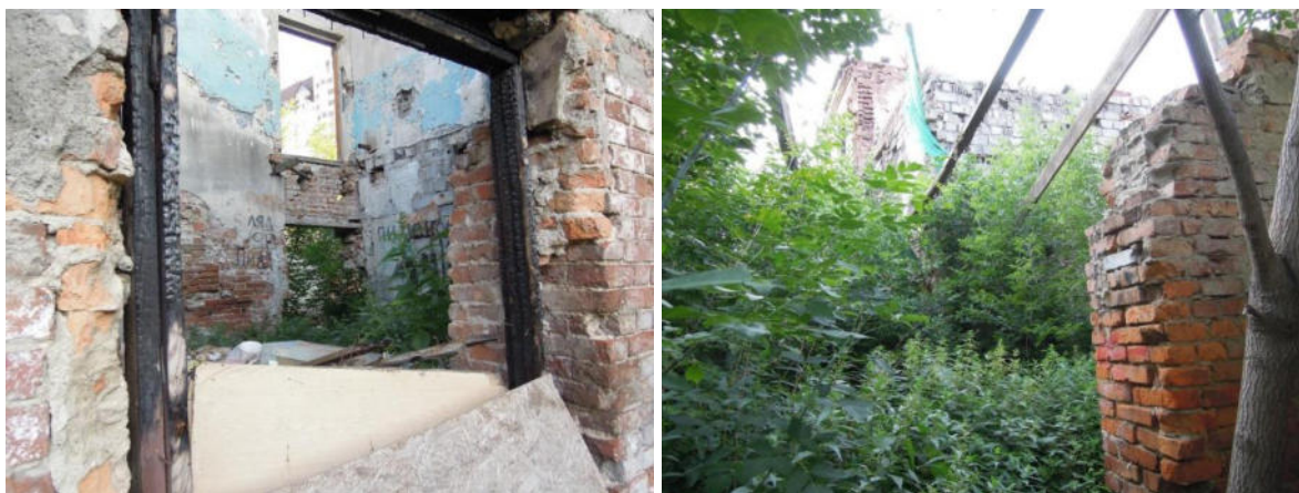
Рис.41. Объект культурного наследия регионального значения «Хозпостройки (перестроены)» (Свердловская область, г. Екатеринбург, ул. Октябрьской революции, 33а). Слева – сгоревшие в результате пожара деревянные конструкции в объёме бывшего завода фруктовых вод. Вид со двора. Справа – разрушенные перекрытия и поздняя кладка из шлакоблоков в том же объёме. Вид со стороны междомового проезда от ул. Маршала Жукова. Фото Т.С. Старцевой, июнь, 2021 года.
