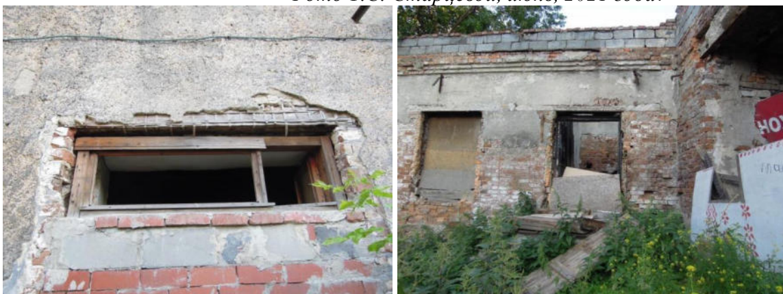
Рис.40. Объект культурного наследия регионального значения «Хозпостройки (перестроены)» (Свердловская область, г. Екатеринбург, ул. Октябрьской революции, 33а). Слева – заложенный оконный проем на бывшем здании склада. Справа – растёсанные проёмы в объёме бывшего завода фруктовых вод. Виды с внутриворотовой территории. Фото Т.С. Старцевой, июнь, 2021 года.
